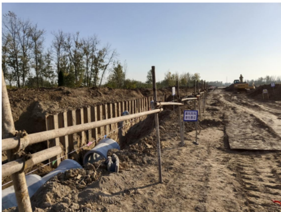
图3 基坑防护情况（自北向南拍摄）
