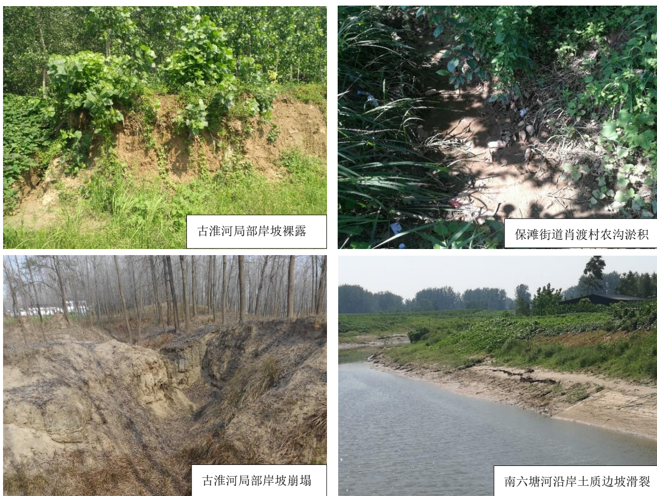
图 2-1 涟水县部分地区水土流失现状
